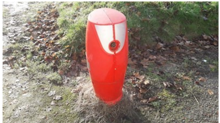
Photo de l'hydrant
