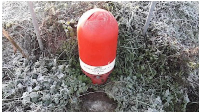
Photo de l'hydrant
