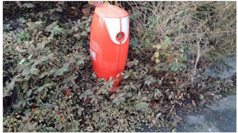
Photo de l'hydrant
