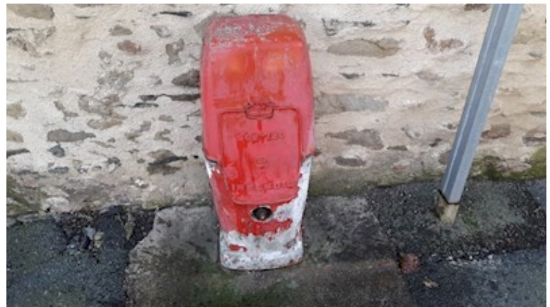
Photo de l'hydrant
