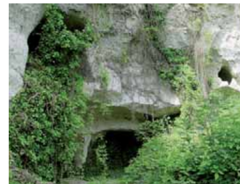
DÉFAUT D'ENTRETIEN DE LA VÉGÉTATION
