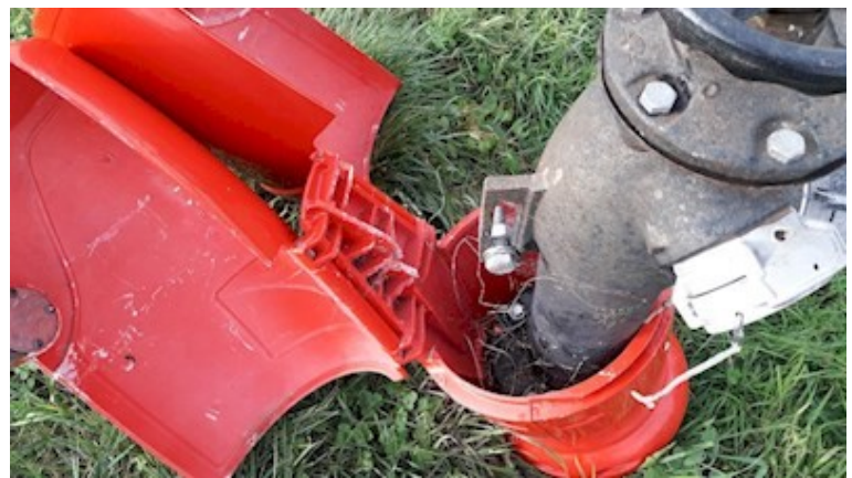
Photo de l'hydrant
