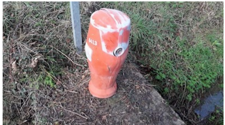
Photo de l'hydrant
