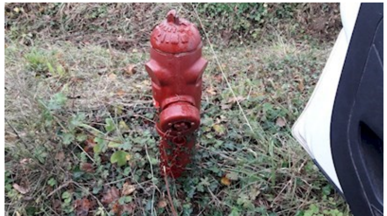
Photo de l'hydrant
