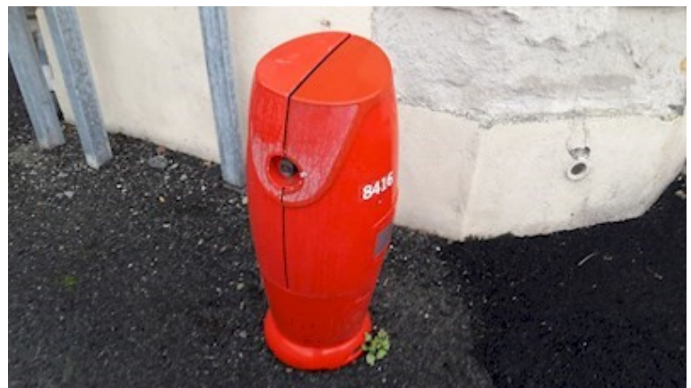
Photo de l'hydrant
