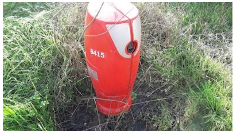
Photo de l'hydrant
