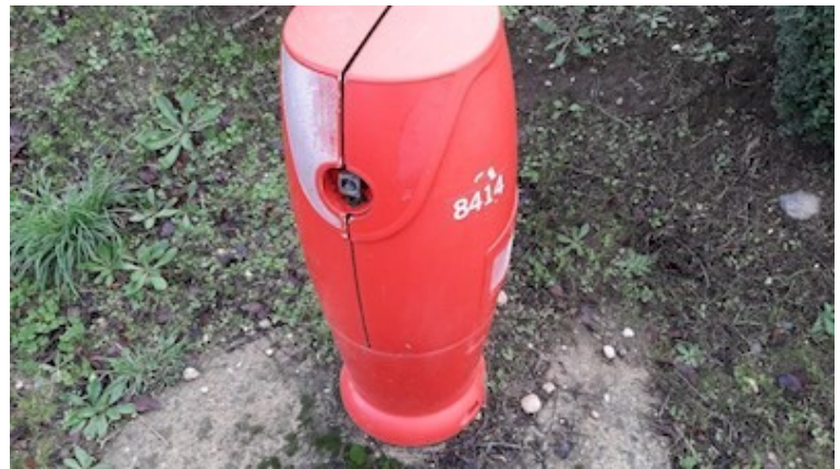
Photo de l'hydrant
