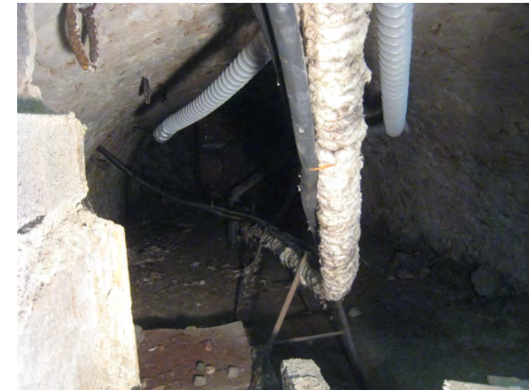
Photo 3: Vue de la cave du particulier sise au 16 place Robert Lefort
