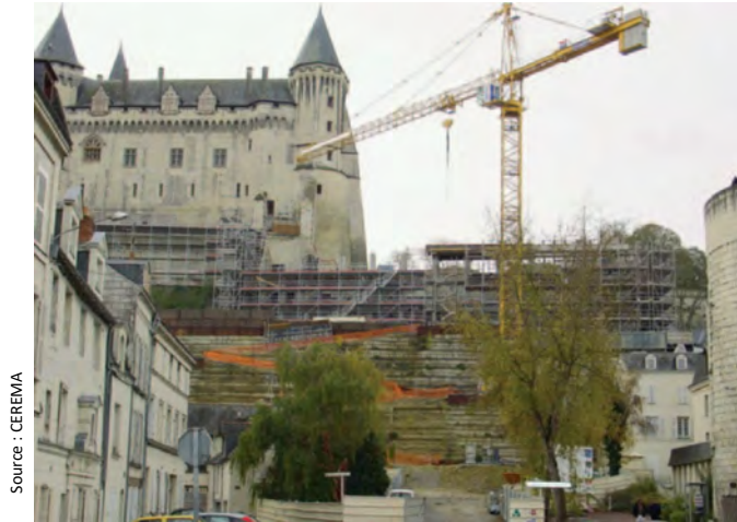
Effondrement des remparts château de Saumur
